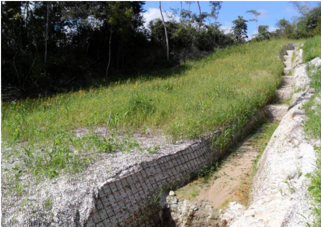
FIGURA 24 – VISTA CANALETA VEGETADA COM GABINETE METÁLICO, VEGETAÇÃO E MANTA GEOTÊXTIL. TÉCNICA FEITA DO TIPO ESCADA.
